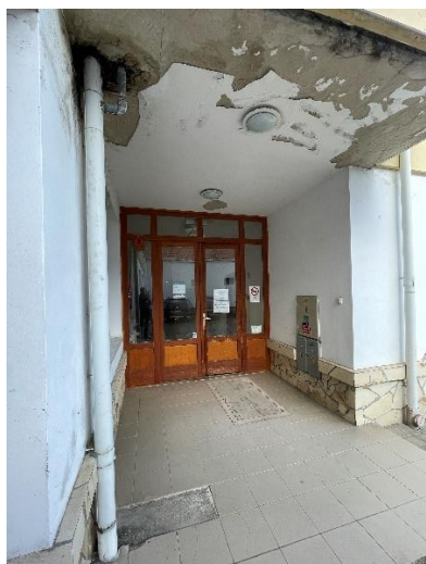
Bejárat az épületbe. A terasz elégtelen szigetelése beázáshoz vezetett, a vakolat mállik
